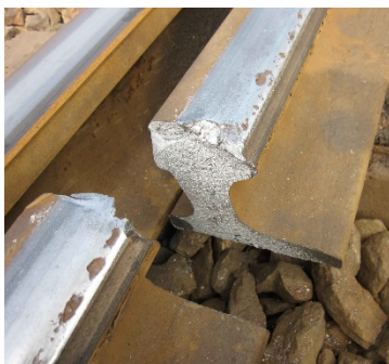
道岔尖轨断裂 Разлом острька стрелочного перевода
